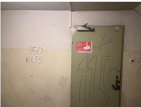
Anlage 5: Beschmierungen im Kellerbereich
