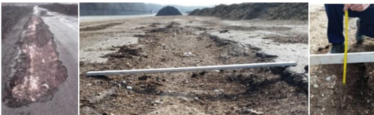
Abb. 26: Kompostwerk Lobau, Schäden auf der Rottefläche (Quelle: MA 48)
